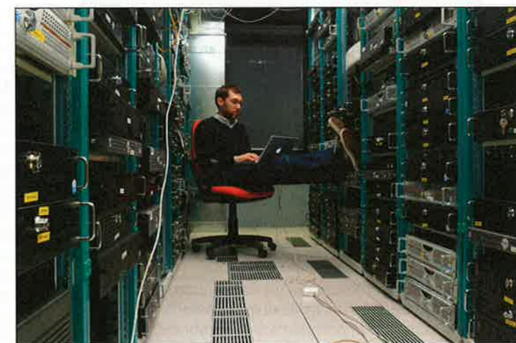
Un rayonnage de serveurs dans un datacenter : des centaines de machines à héberger.
